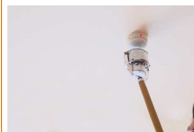
自動火災報知設備の点検 ※住宅用防災警報器に法定点検義務はありません。
