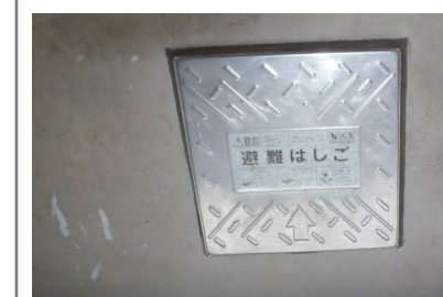
避難はしごのハッチ 実際に動かして不具合が無いか確認します。
